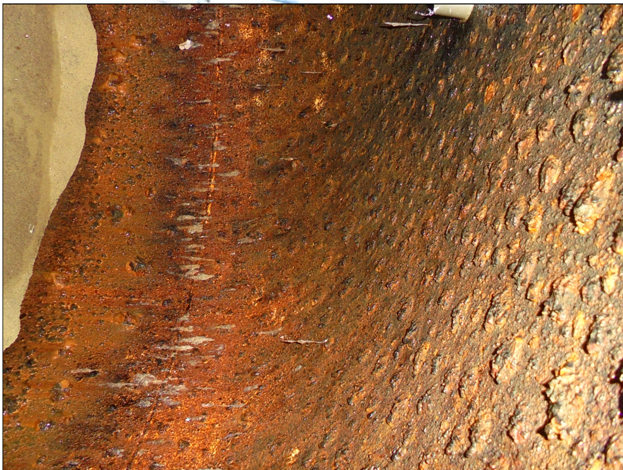
Rysunek 17 FILTR II 2.3 (widok kopuły i ściany bocznej filtra)
