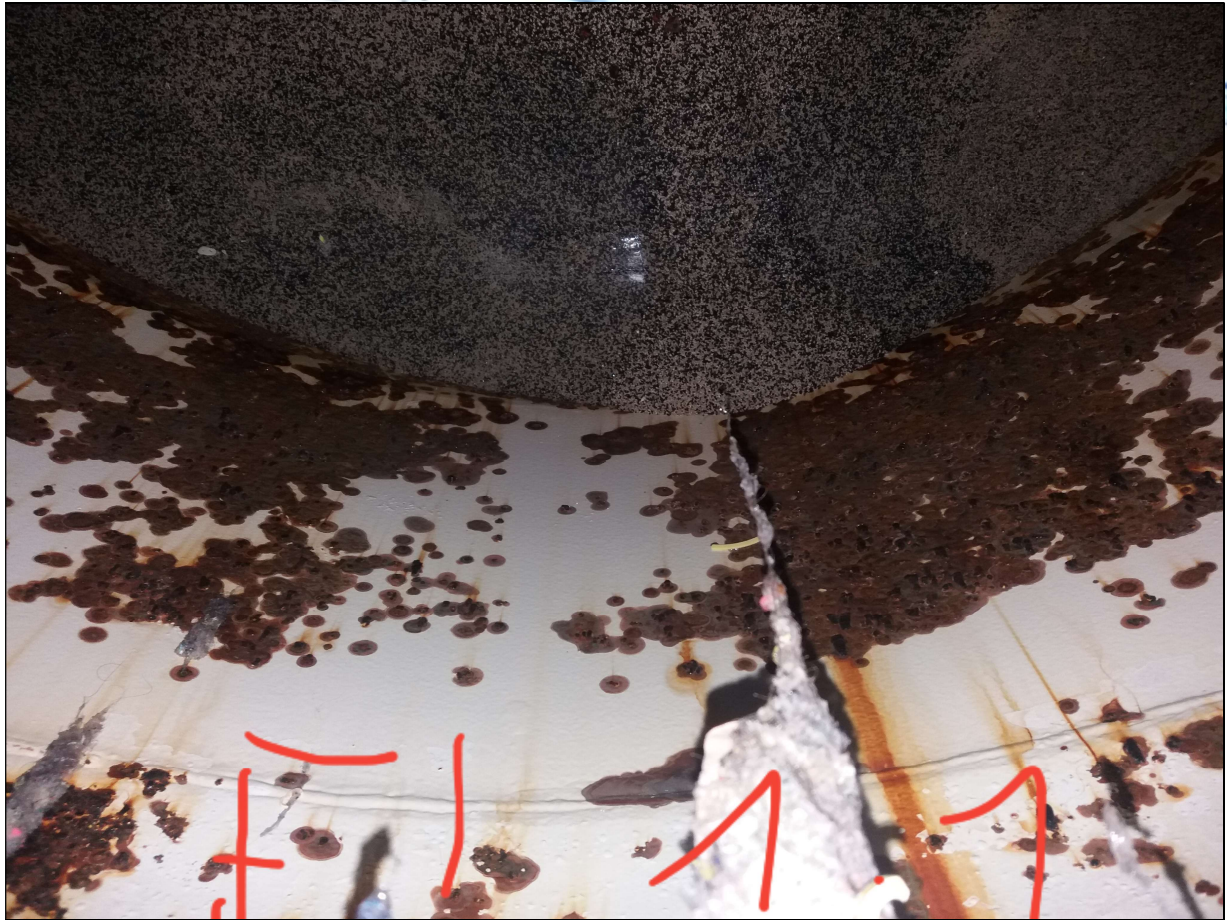
Rysunek 4 FILTR FI 1.1 (widok złoża filtracyjnego i ściany bocznej filtra)
